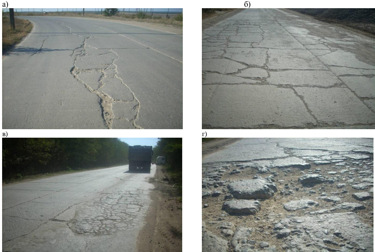
Рис. 3. Етапи розвитку руйнувань жорсткого цементобетонного дорожнього покриття, де а - поздовжні тріщини, що переходять у вибоїни; б - блочні тріщини; в - сітка тріщин, проломи ц/б плити; г - викришування, вибоїни, руйнування більше 75% площі плит
