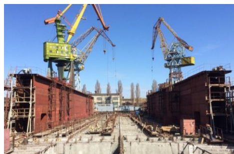
Рисунок 6 – постройка композитного автономного плавучего дока грузоподъемностью 7100 т в Херсонском государственном заводе «Паллада» [7]
